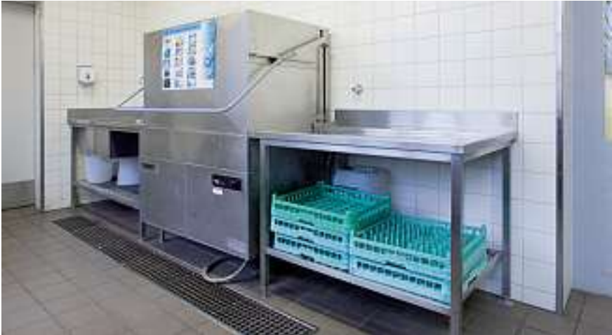
Zone de nettoyage
